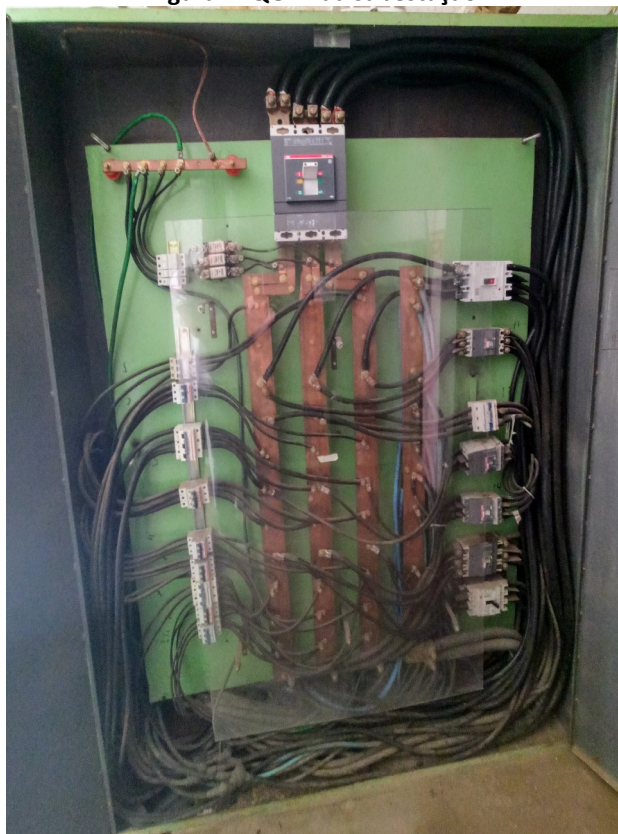
Figura 7: QGBT da subestação.
