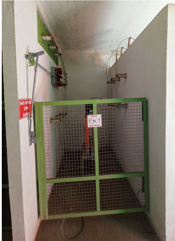
Figura 3: Cubículo de proteção.
