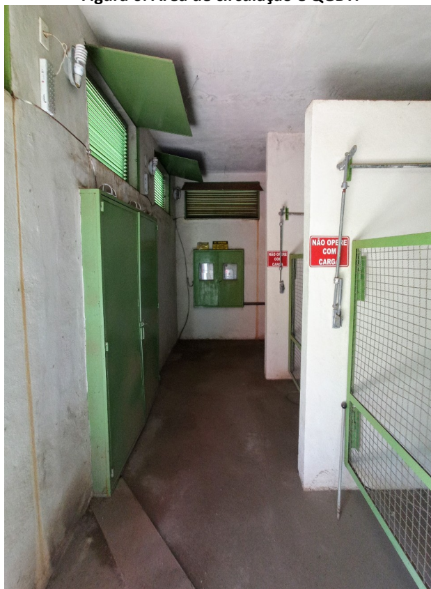
Figura 6: Área de circulação e QGBT.
