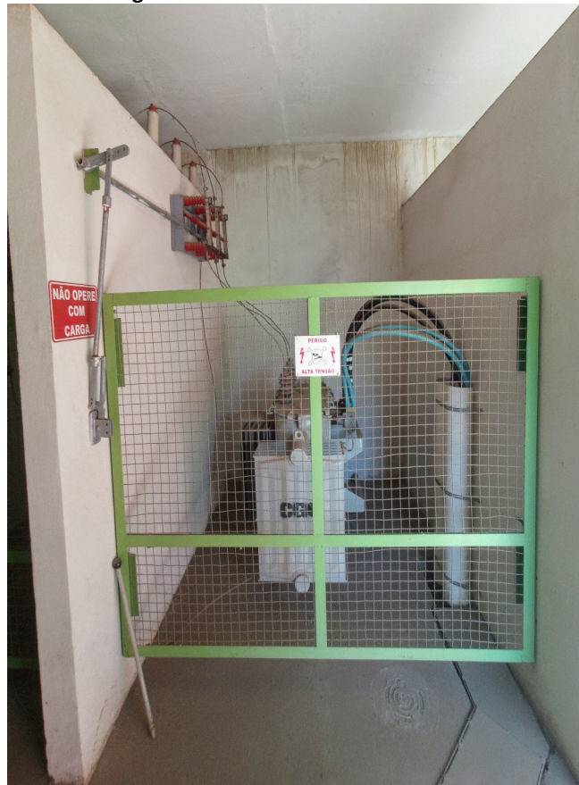
Figura 4: Cubículo do transformador.
