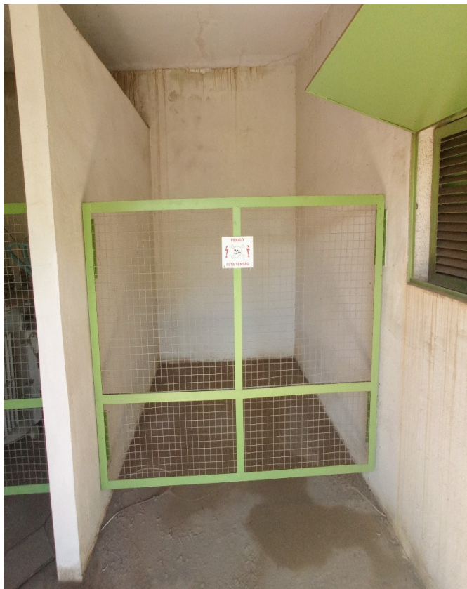
Figura 5: Cubículo vago para futura instalação de transformador.
